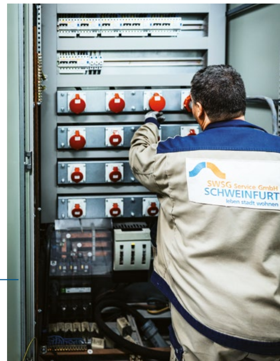
Alle Sicherungen im Griff, Eishalle Schweinfurt
