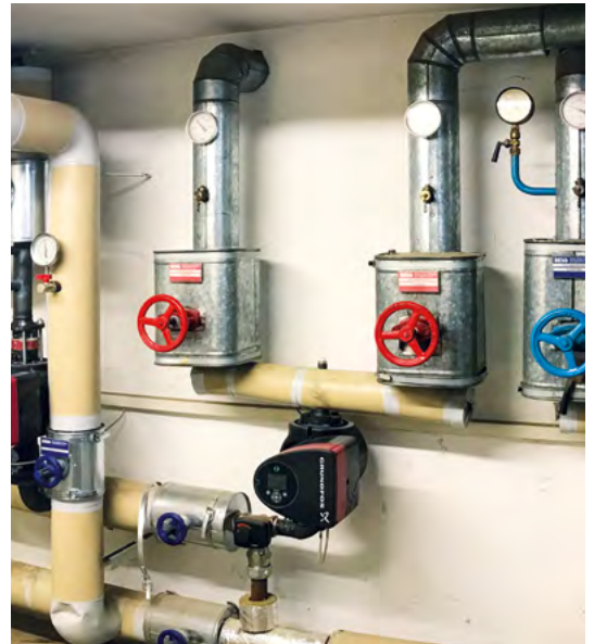
Nahwärmeleitung zur Versorgung von Merckstraße 12–16
