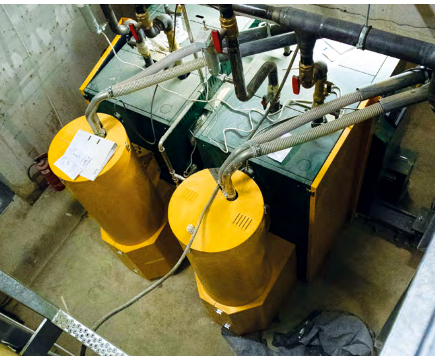
In der Heizzentrale ermöglichen zwei Pelletkessel einen unterbrechungsfreien Betrieb der Heizung und der Warmwasserbereitung.
